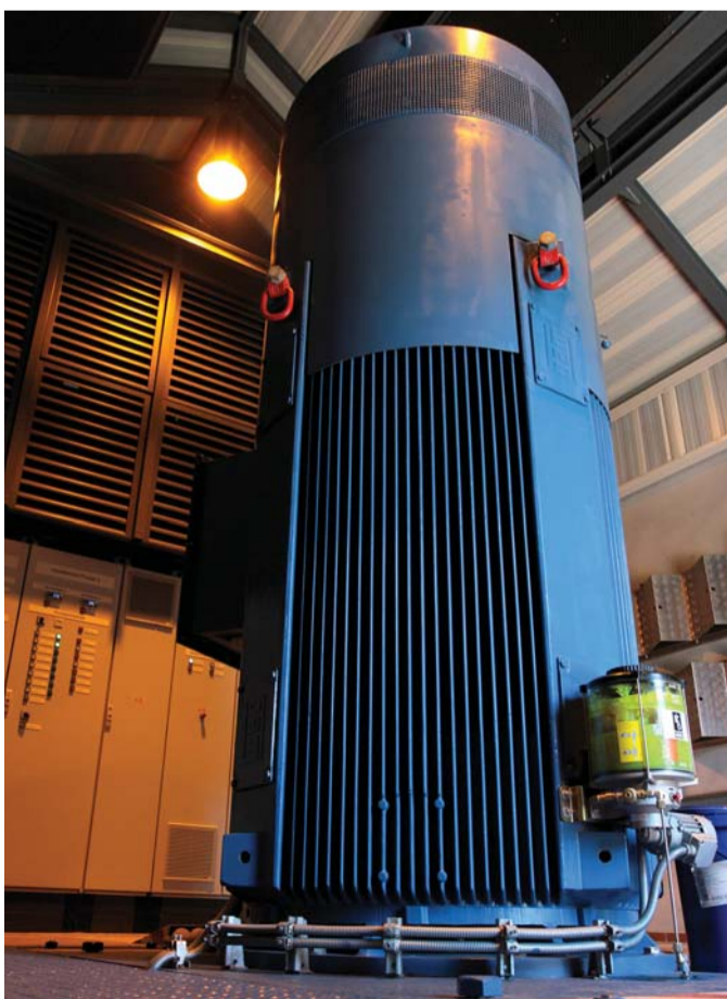
Wasserpumpe, wie sie in Schöpfwerken zum Einsatz kommt (Foto: DHSV Dithmarschen)
